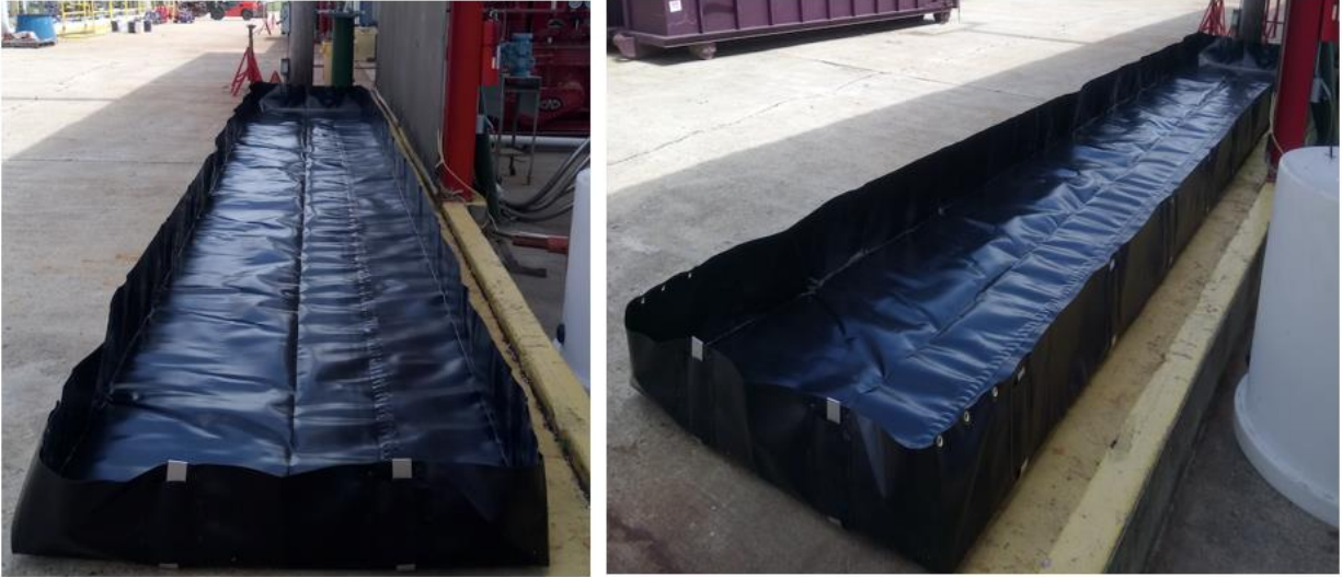
Fig. 19. Geomembrane for spill containment
